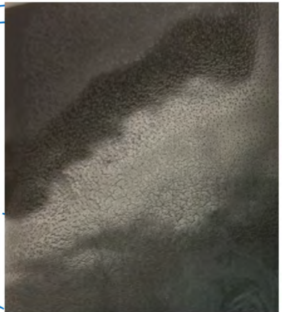
Bild 37. Detalj av tecken på nedbrytning.
