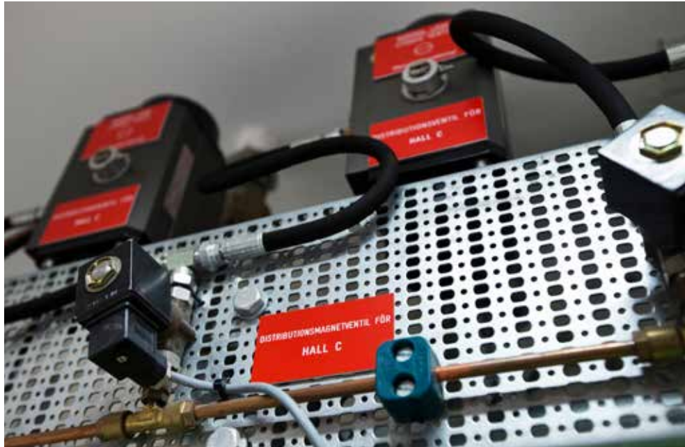
Bild 9. Utrustning för att fördela släck-gas till separata utrymmen.
