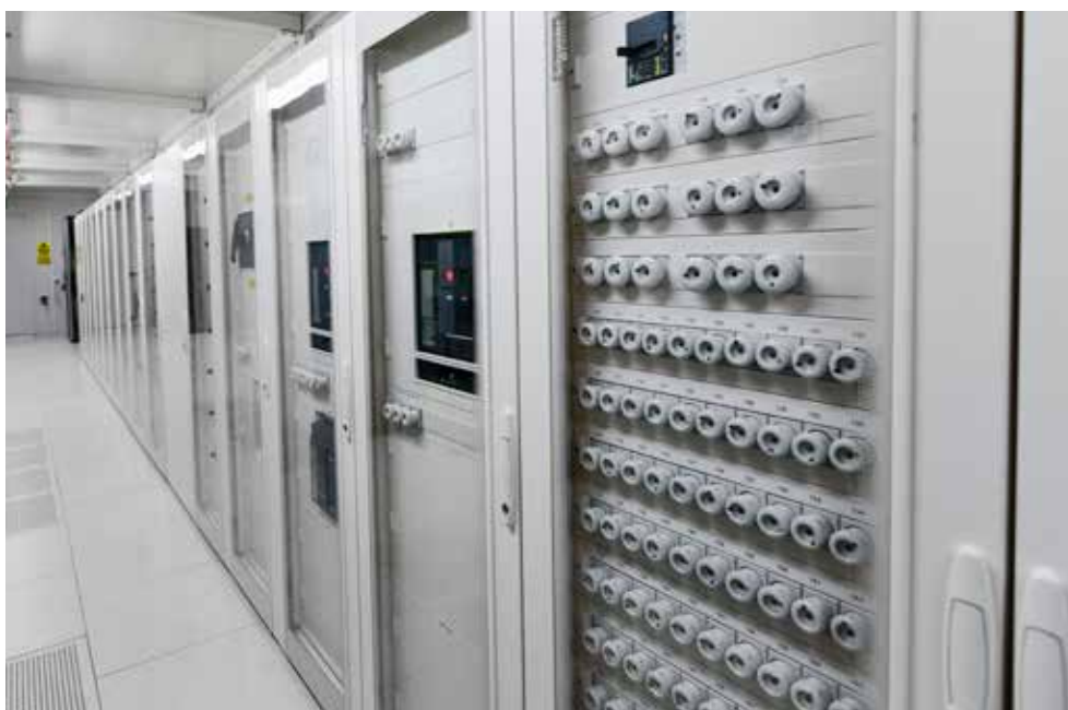
Bild 14. Ställverk som matar it-utrymme placerade i separat utrymme skilt från it-utrustning.
