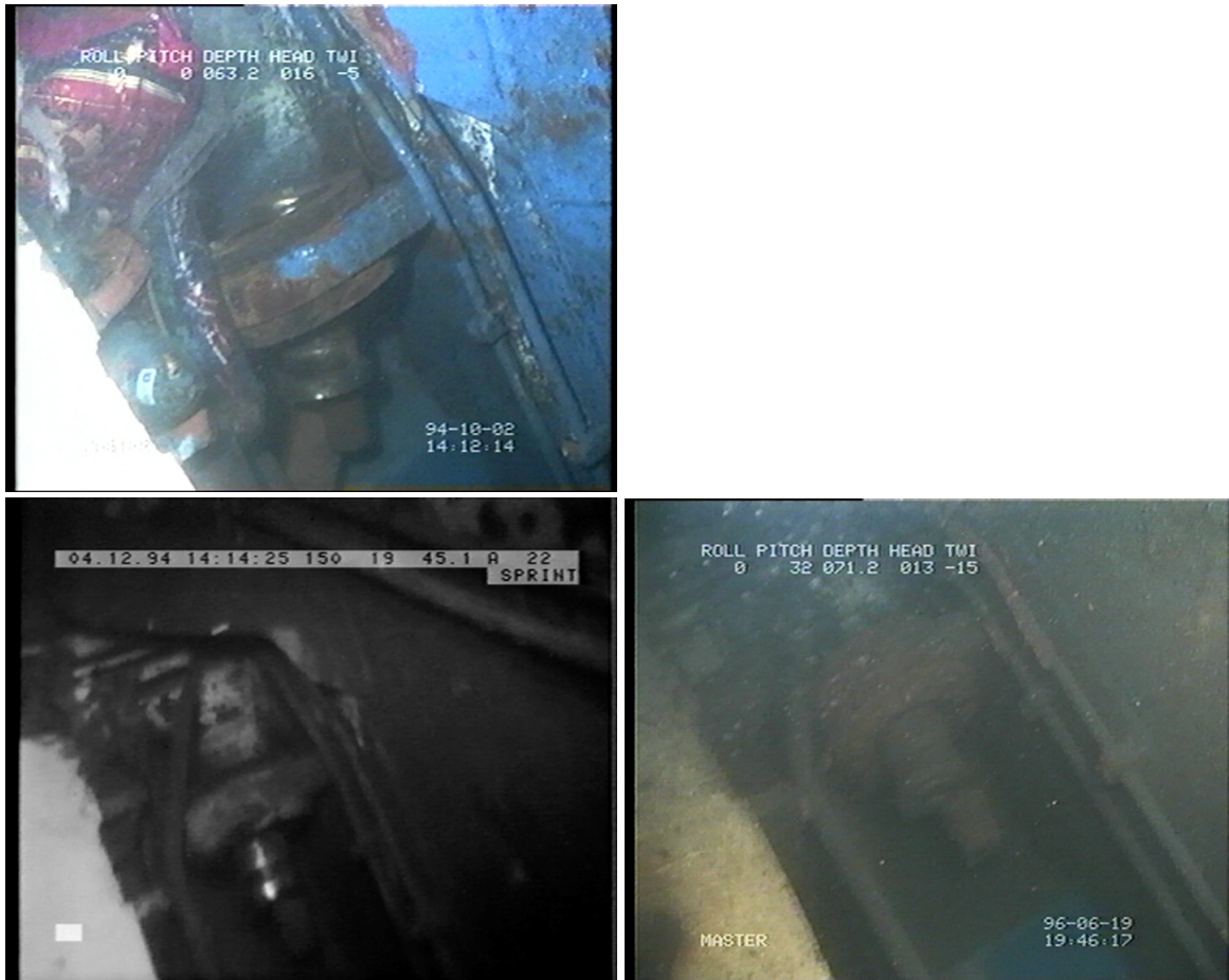
Figur 7. Bogrampens yttre gångjärn på babord sida. Överst från material 08 vid tidsangivelsen 14:12:14, nere till vänster från material 30 vid tidsangivelsen 14:14:25 och nere till höger från material 11 vid tidsangivelsen 19:46:17.
