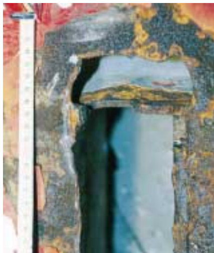
Figur 12.22 Bristning på platsen för babords sidolåsöra vid horisontella stringern.
